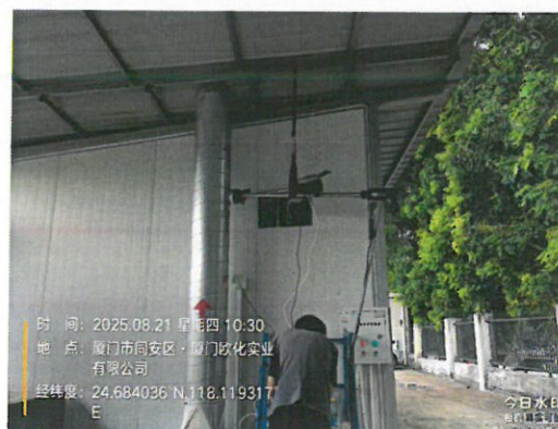
DA002 危废间有机废气排放口
